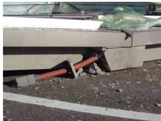
写真 9 ロッドが圧縮になって抜け落ちる
