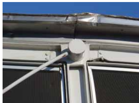
写真 11 鉄骨梁の曲げ座屈
