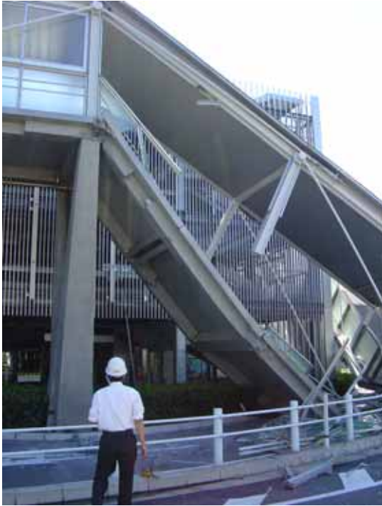
写真 6 佐渡汽船側支柱・右側だけが落下
