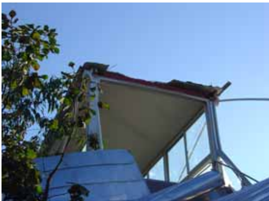
写真 10 朱鷺メッセ側だけが上弦材鉄骨が破断
