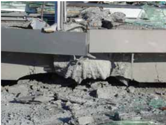
写真 8 ロッド定着部の破壊
