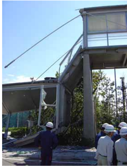
写真 7 朱鷺メッセ側支柱・左側だけが落下
